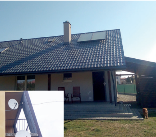
Kolektory słoneczne na dachu, na jednym z budynków w gminie Dukla objętych programem
