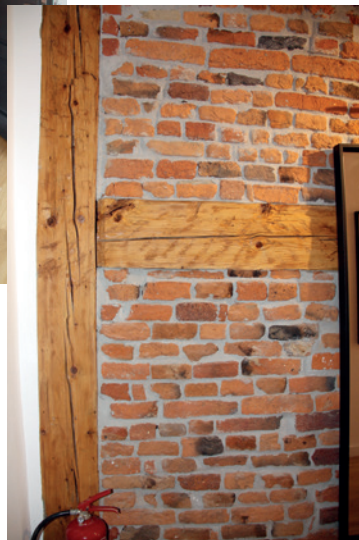
Stare, ręcznie wykonane cegły odkryte na korytarzu w kamienicy z belkami
