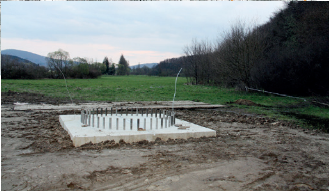
Fundament do słupa linii wysokiego napięcia
