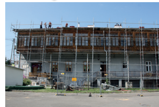
Elewacja wschodnia - do remontu
