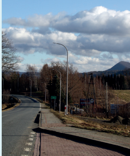
Oświetlenie uliczne przy drodze nr 933 na pograniczu Iwli i Głojsc
